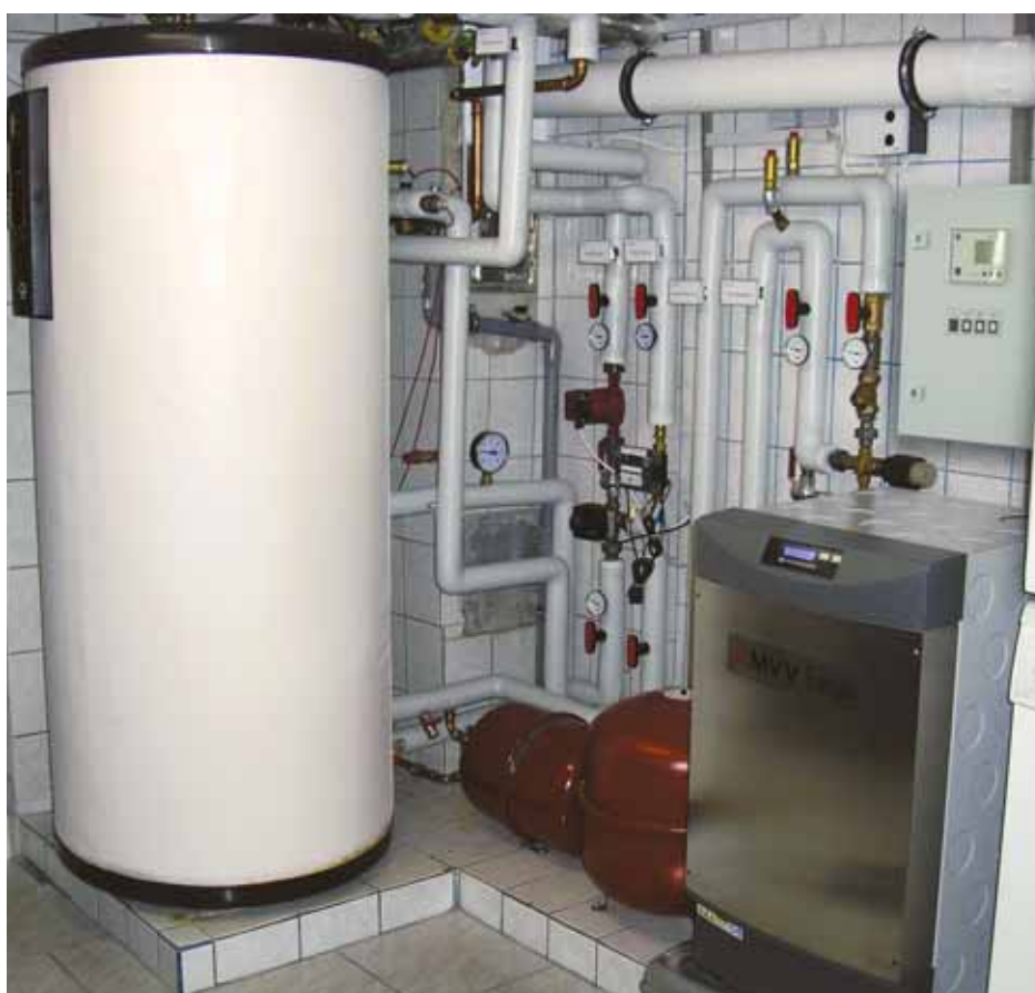
Typische Installation einer Hausenergieanlage, bestehend aus WhisperGen-BHKW, Pufferspeicher und Steuerungseinheit
